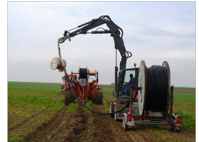
Photo 151 : Pose d'un câble HTA à 1,20 m avec la méthode du soc tracté (source VALOREM)
